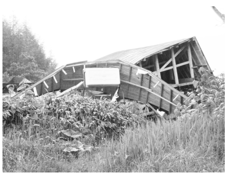
雪の重みで倒壊した公共施設(スキー場)
